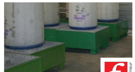
Stockage des liquides dangereux sur bac de rétention
