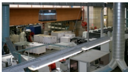
Récupérateur de poussière et lumière bleue pour la propreté de l'environnement machine
